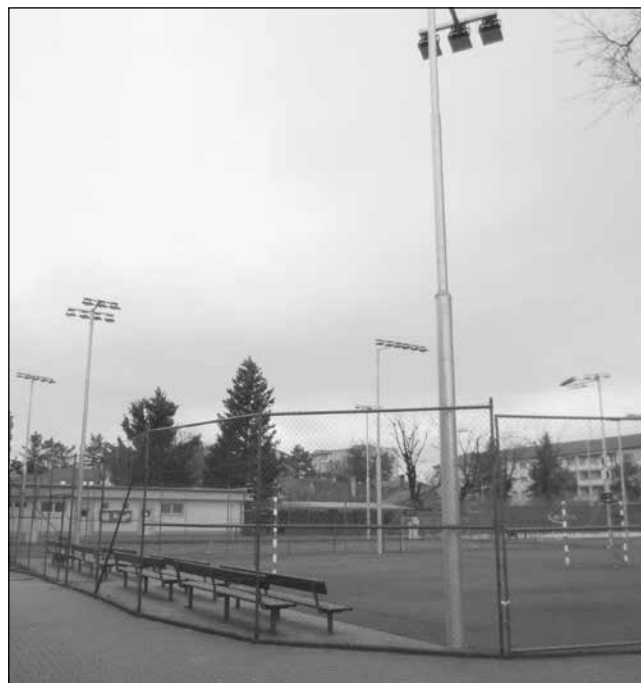
Osvětlení kurtů na sokolovně
