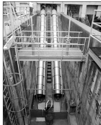
Nová šneková čerpadla ve vstupní čerpací stanici
