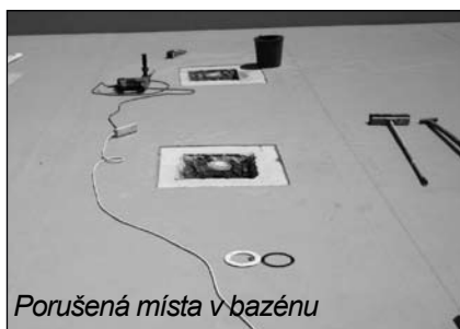
Závada ve dně velkého bazénu
