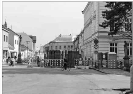
Hluboká kanalizační šachta na nám. Míru způsobuje neprůjezdnost tohoto náměstí.
