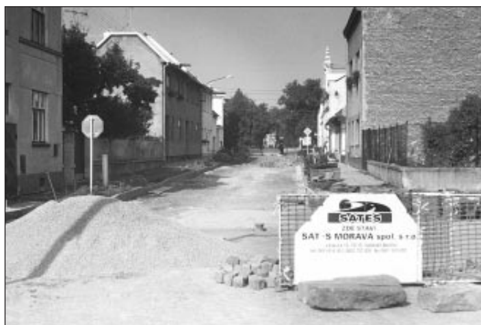
Předlažba vozovky a chodníku v Haulíčkově ulici včetně vybudování parkovacích míst u polikliniky
