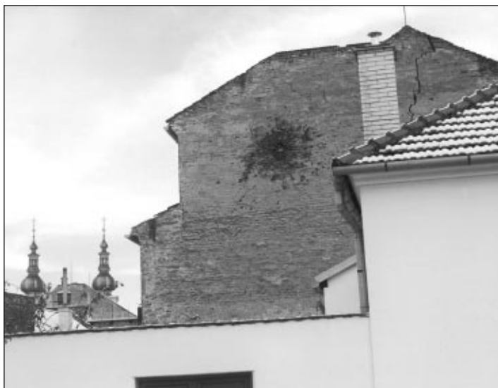
Jednou z posledních připomínek 2. světové války je porušená zeď od letecké pumy na domě v ulici Sv. Čecha.
